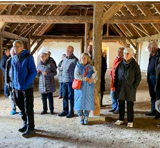
De mange åbent-hus-gæster fik også et indblik i Nørre Sødams egnsspecifikke tømmerkonstruktioner; her i lade, der er opført i en såkaldt højremskonstruktion.
